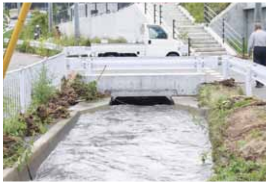
台風18号翌日の沢山地区水路
