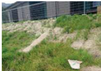
復旧が必要な災害公営住宅ののり面
