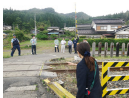
吉里吉里踏切（塚花街道） 段差が大きく、埋め込みの木も傷んでいる。
