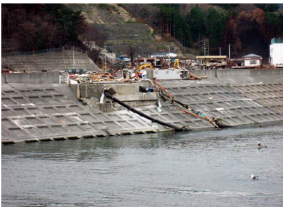
津波で破壊された安渡橋。同時に水道管も破損した
