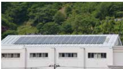
役場庁舎に設置の太陽光パネル
