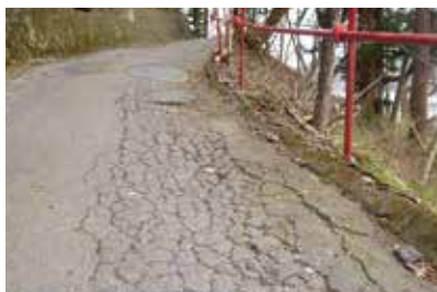
地域住民から整備要望が出ている避難道路
