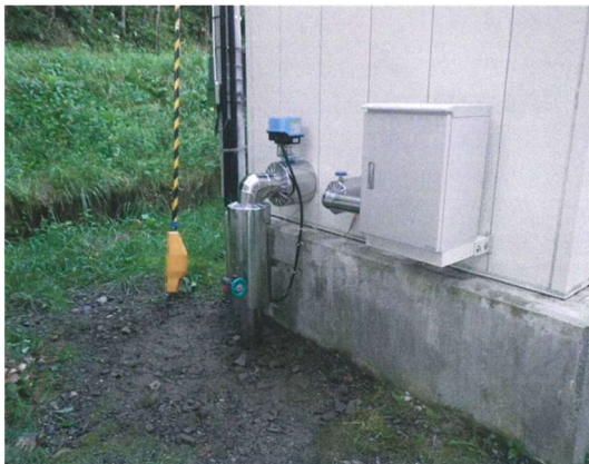
非常用給水設備
