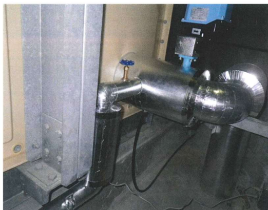
非常用給水設備
