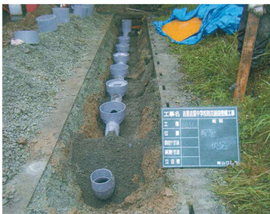
災害用トイレ配水管
