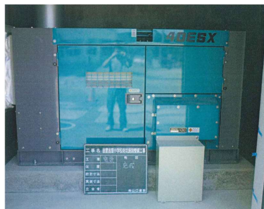
自家発電設備
