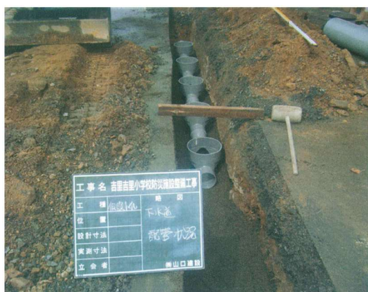
災害用トイレ配水管
