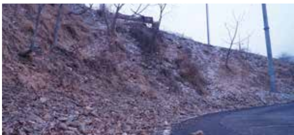
鹿食害による道路側面
