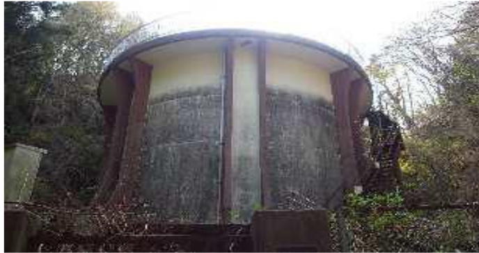
昭和57年築 吉里吉里第1配水池 (PC造 容積= 603 \text{m}^3 )
