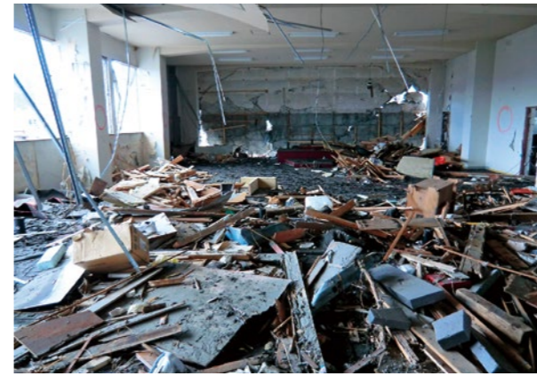
がれきが散乱する中央棟北側2階の会議室(2011年3月18日撮影)。津波は天井近くまで達した
