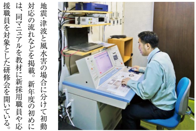
中央公民館の災対本部に設置された防災行政無線の操作卓
