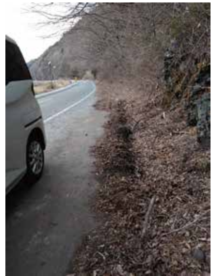
町道小鎚線の道路側溝に堆積する土砂等
