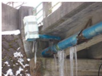
配水管の老朽化による漏水
