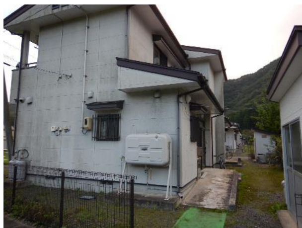
一部、外壁に汚れあり
