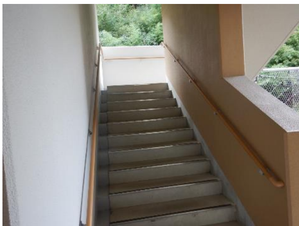
共用階段(手すり付)
