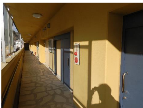
床(共用廊下側、亀裂補修あり)
