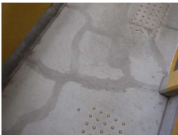
共用階段(補修後、新たなひび割れ)
